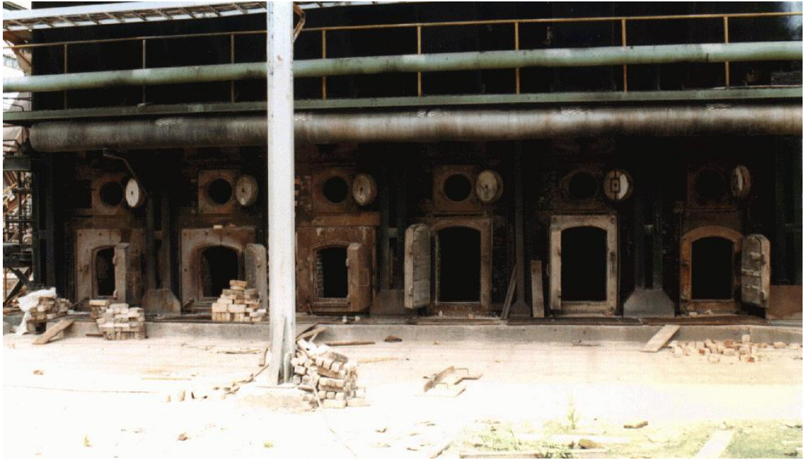
Foto 18 – Uma parte do bagaço é queimada nas fornalhas para aquecer...
