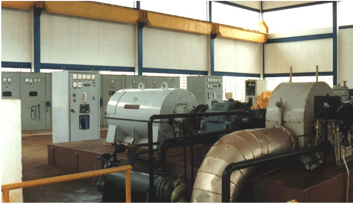
Foto 20 – ...girar as turbinas, que vão gerar eletricidade...
